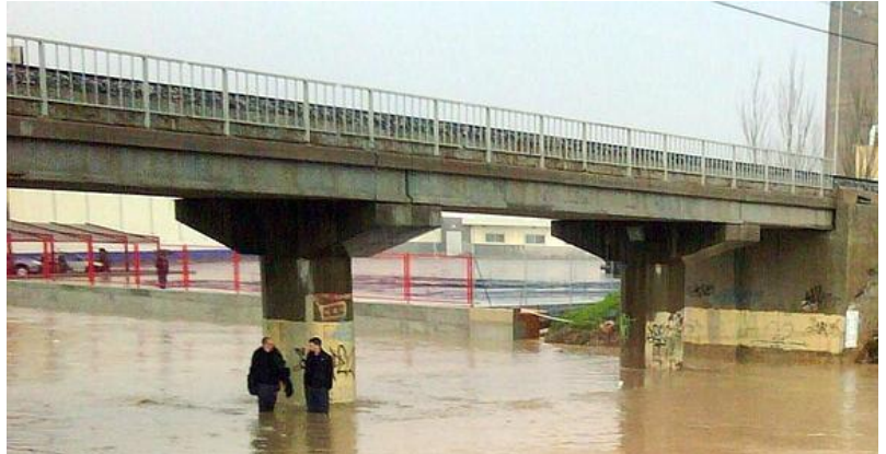
Zona inundada en el Polígono Guadalhorce tras unas intensas lluvias (archivo). / SUR
